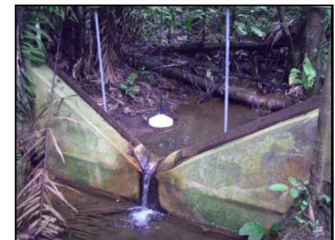
Vertedor instalado en el OHTCP
