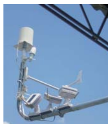
Figura 4: Estación meteorológica Oregon Scientific WMR968 instalado en un brazo metálico anclado a una de las vigas de techo.
